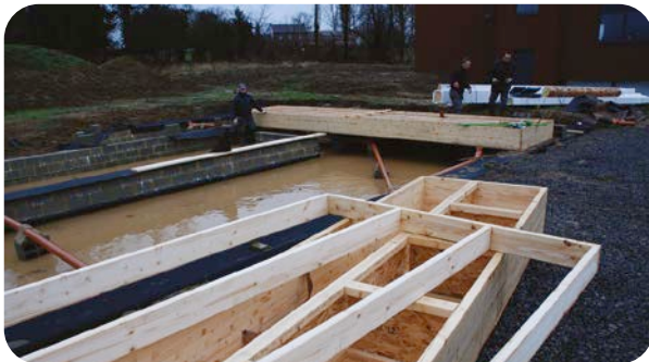
Uitvoering van een houten vloer boven een kruipruimte die niet voldoet aan de aanbevelingen uit TV 291.
