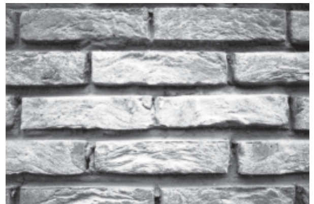
Nécessité de corriger la largeur et la profondeur du joint.
