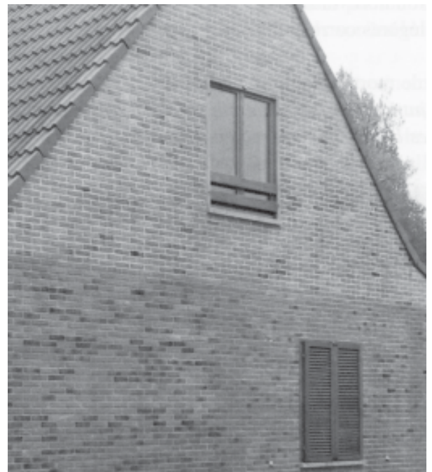
Différence frappante d'aspect d'un mur jointoyé.
