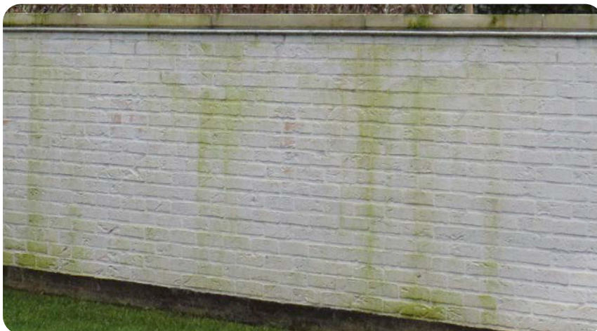
1 Voorbeeld van de vroegtijdige vergroening van een geschilderde gevel.
