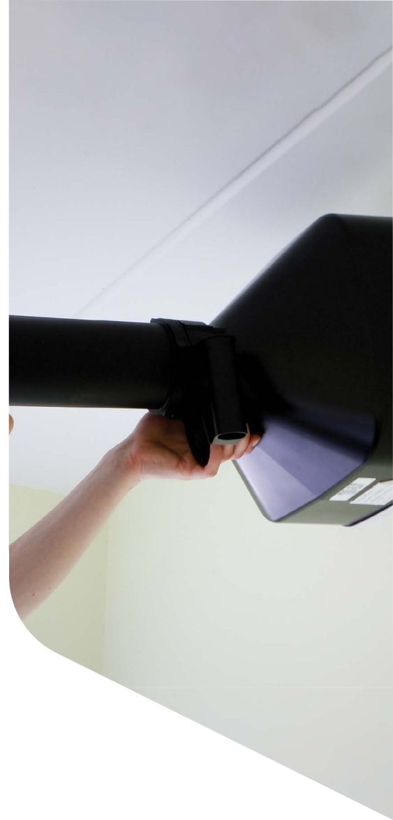
Afb: Meting van mechanische ventilatiedebieten ter hoogte van een ventiel
