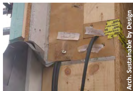
Fig. 62 Assemblage à mi-bois et étanchéité à l'air par joint à lèvres en caoutchouc (Londres).
