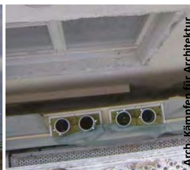
Vue de haut d'un module AIM-ES révélant les conduits de ventilation
