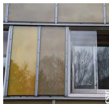
Fig. 53 Entrée et sortie d'air apparentes de groupes de ventilation décentralisés (en haut) ou dissimulées derrière un vitrage (en bas).
