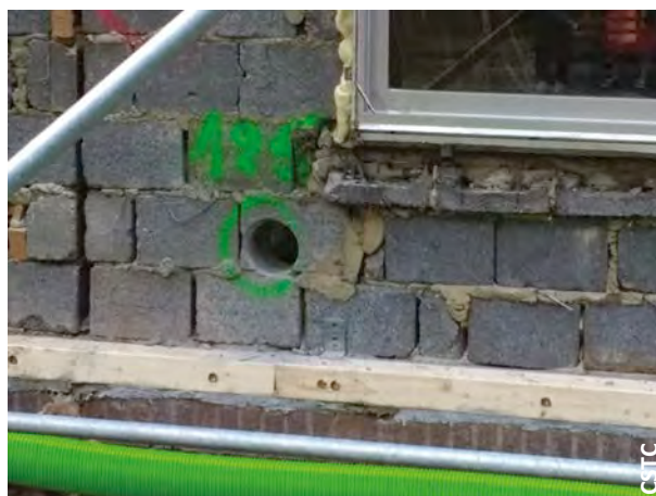
Fig. 83 Orifice foré dans un mur existant pour raccorder un conduit de ventilation (projet de rénovation expérimentale Ecoren).
