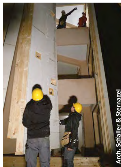
Fig. 29 Rôle joué par la forme particulière du bâtiment (balcons complexes) dans le choix de l'orientation verticale des modules (illustration : Berlin) [80].
