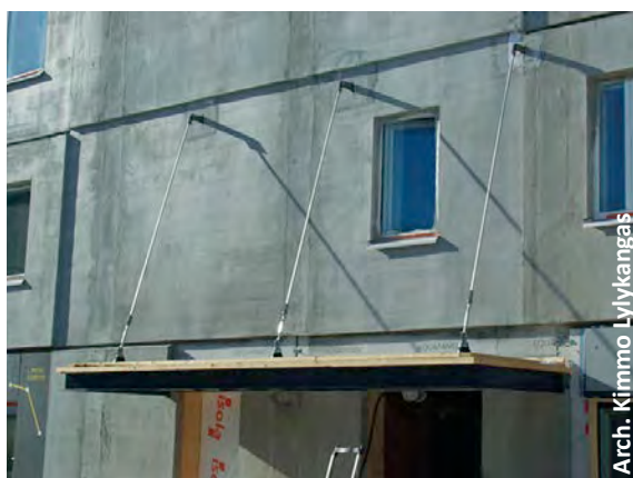
Fig. 92 Éléments architecturaux supplémentaires fixés sur les modules à Riihimäki [56].
