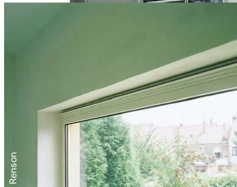
9 | Om het risico op schimmelvorming en condensatie te beperken, moet men in een doeltreffend ventilatiesysteem voorzien.
