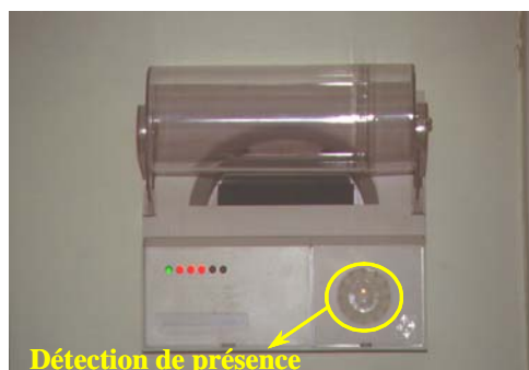
Figure 30 : Détection de présence dans les bureaux
