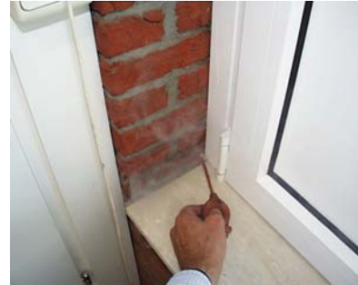
Figure 9 : Visualisation par fumigène des fuites à l'angle des nouveaux châssis
