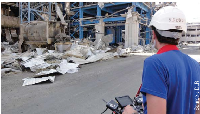
Fig. 48 Analyse de dégâts sur site, suite à une explosion.
