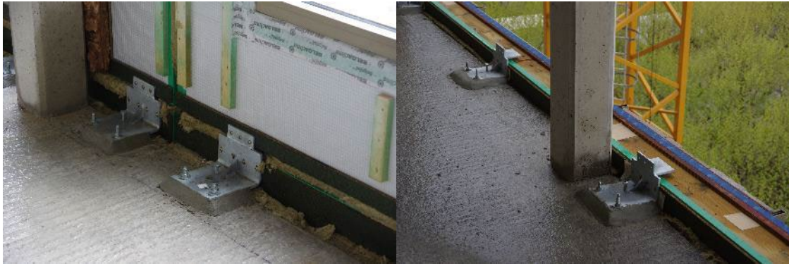
Afbeelding 33 – Vlamdicht gevelelement E 60 uit houtskeletbouw, bevestiging R 60 boven de vloerplaat en brandwerende afdichting EI 60 ter hoogte van de zijkant van de vloerplaat.
