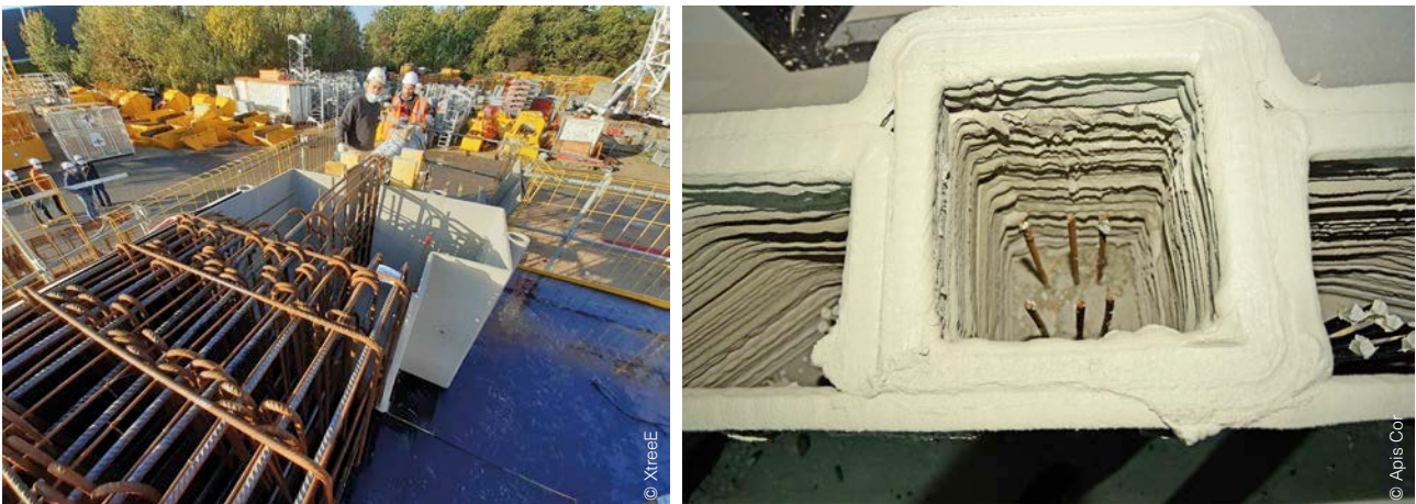
Afb. 27 Hol 3D-geprint element dat dienst doet als verloren bekisting (links) en beton dat gestort wordt in een geprinte kolom die dienst doet als verloren bekisting (rechts).
