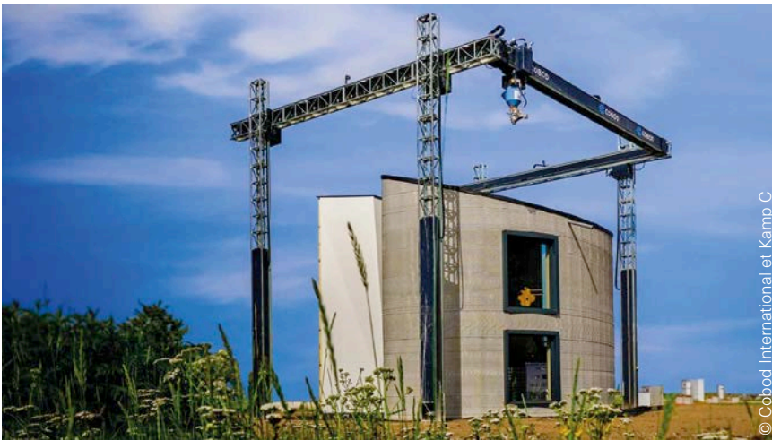
Afb.10 Huis met twee verdiepingen dat geprint werd bij Kamp C in Westerlo.
