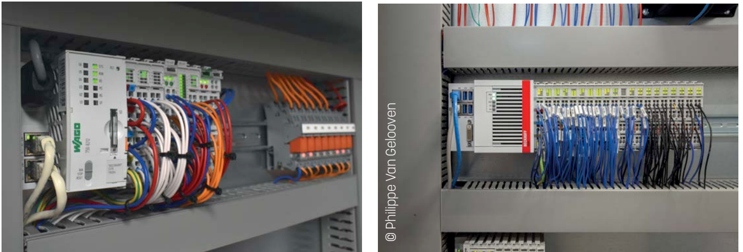
Afb. 18 Voorbeelden van gebouwbeheersystemen die gebruikmaken van een PLC ( programmable logic controller ).
