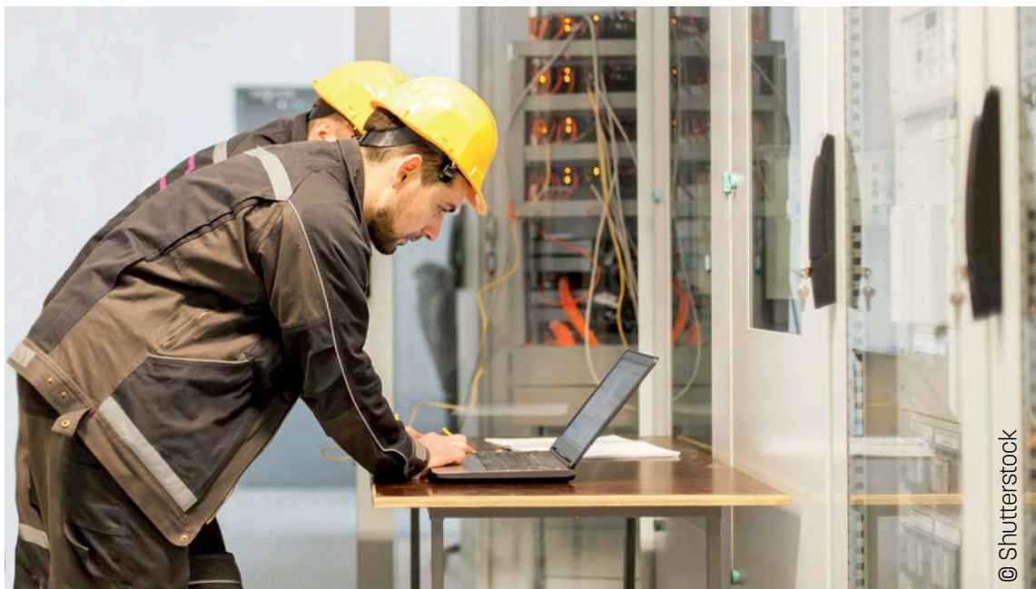
Afb. 16 Het beheer en onderhoud van de slimme systemen is een niet te vergeten aandachtspunt voor smart buildings .
