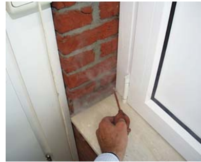
Afb. 9 Visualisatie van de lekken in de hoek van nieuwe ramen door middel van spoorgassen.
