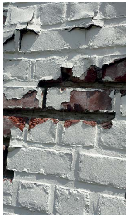
2 | Exemple de dégradation liée à une accumulation d'eau dans la brique : décollement de la peinture, dégâts dus au gel au droit des joints et de la brique
