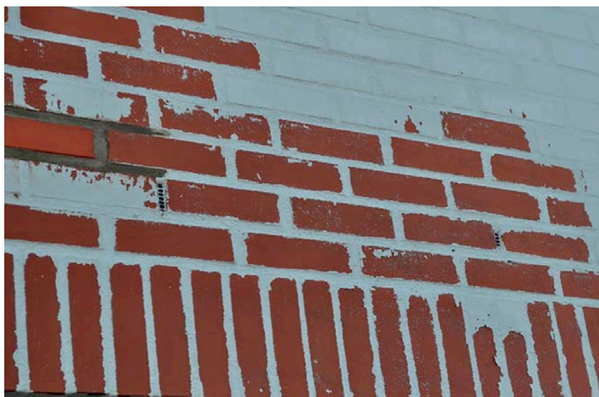
1 | Aspect typique du décollement de la peinture constaté sur différents chantiers
